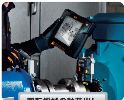
回転機械の軸芯出し
